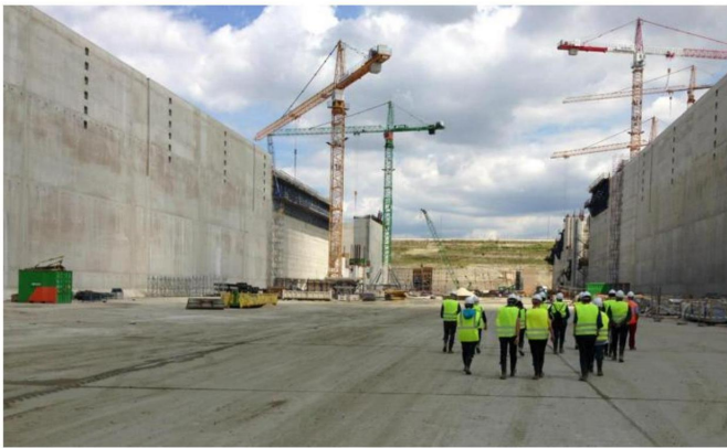
De sluis in aanbouw zal met de naam Kieldrechtssluis door het leven gaan. FOTO IDU
